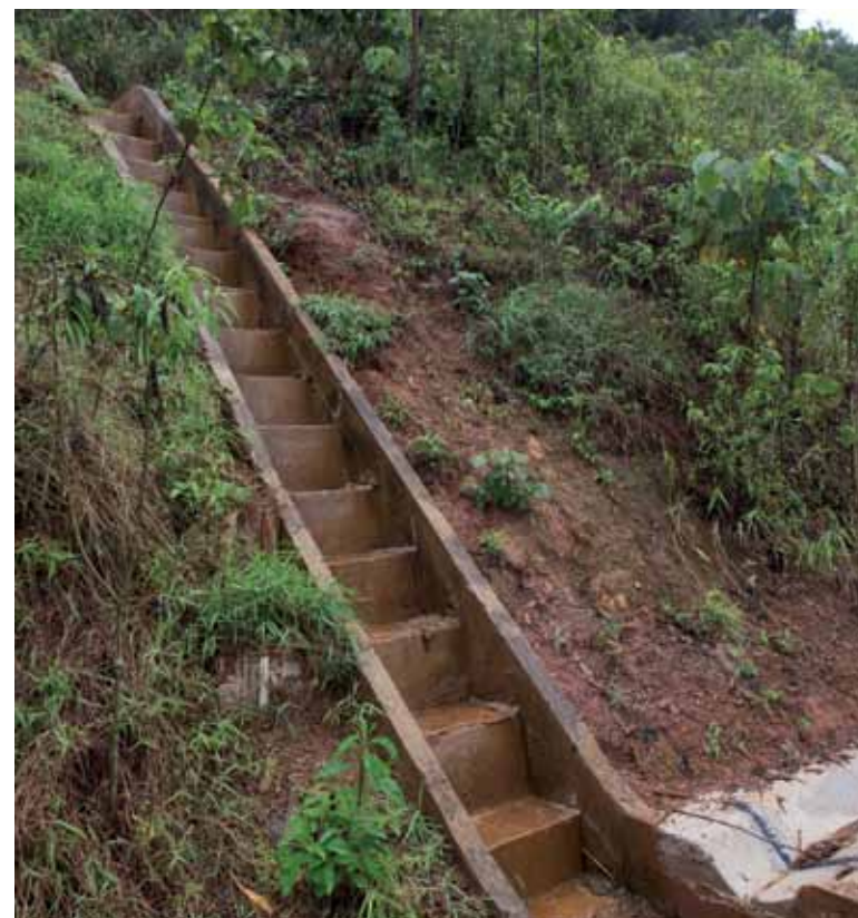
Obra permite o escoamento de água da chuva evitando erosões no solo
